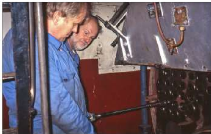
En bild från det stora tubbytet. Åke Karlsson och Bert Johansson pressar en ändra på en rökstaktub så att den kragas ut och tätar mot tubplåten. Foto Gunnar Söderberg 15 oktober 2001.
